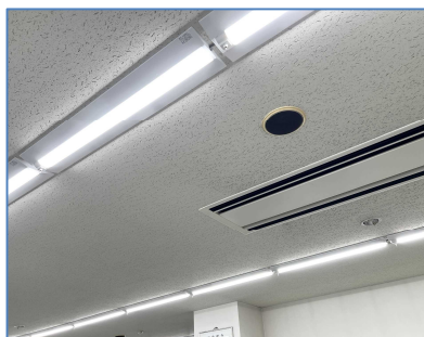
全館LED照明
