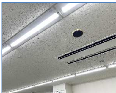
全館LED照明
