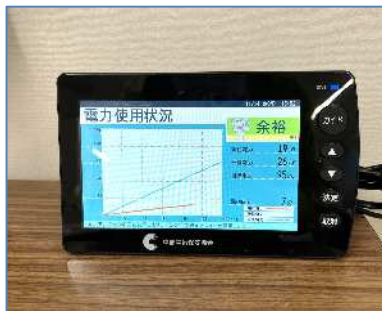
デマンド監視システム
